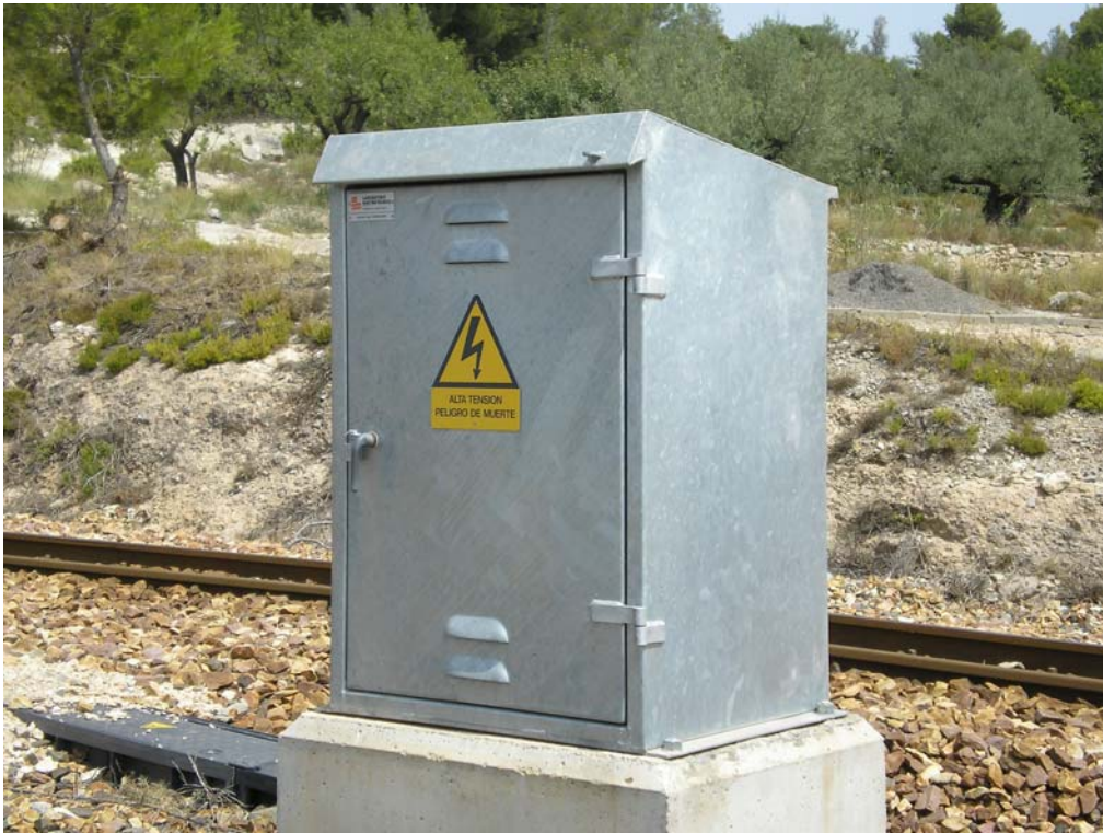
Armario situado en intemperie donde se produce la transformación de 2200v a 220v a la que se alimenta el Puesto Fijo del Tren Tierra.
