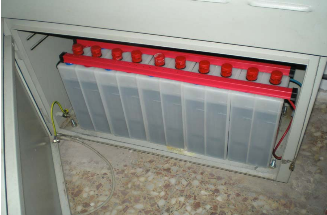
Subrack de Baterías, situado justo debajo del subrack de tarjetas, cuya misión es alimentar el equipo de PF ante una falta de suministro eléctrico, su duración en condiciones óptimas de las baterías y de una temperatura ambiente de 25°C es de 6 horas.
