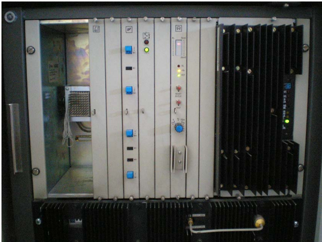
Subrack donde se encuentran las diferentes tarjetas que componen el equipo del PF
