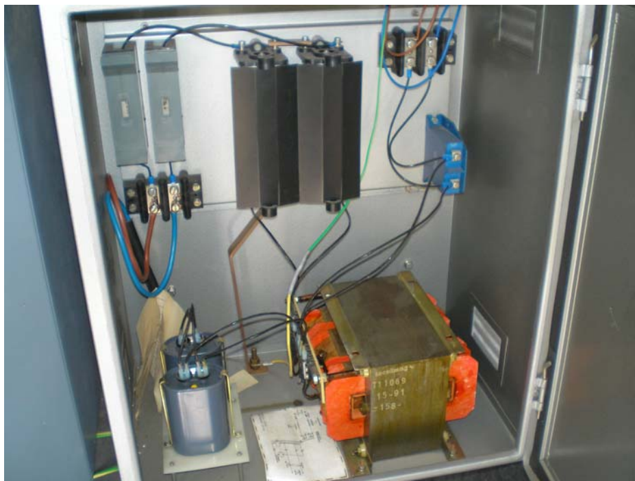
Armario donde se realiza el filtrado / estabilización de la tensión de 220v.
